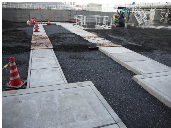
浜田市 三隅町 ダクト(特注品)
